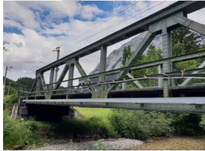
nach der Installation
