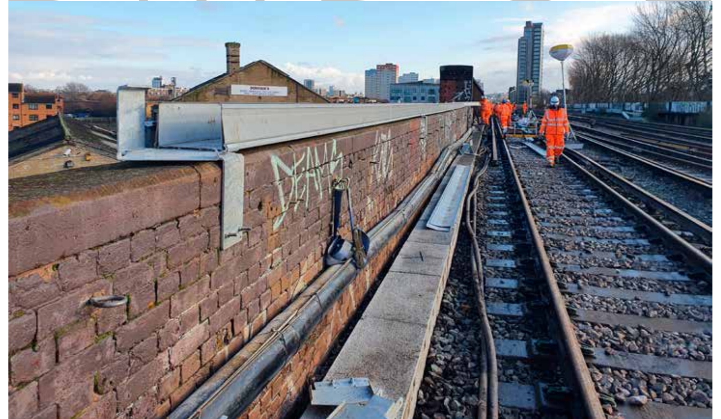
nach der Installation
